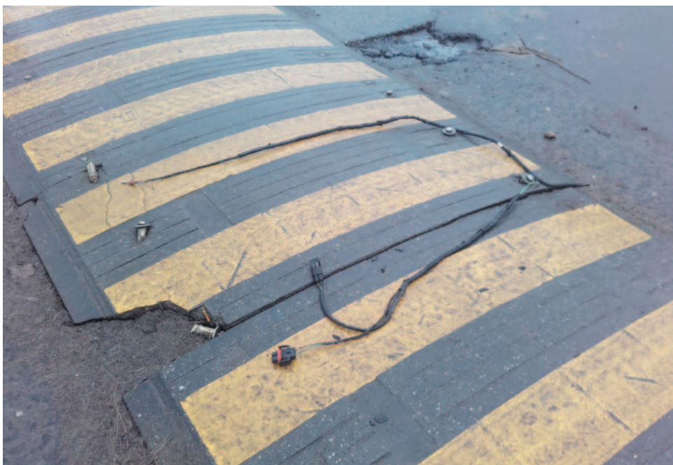
Elementy progów się kruszą, a śruby wystające z progów niszczą instalacje samochodowe
