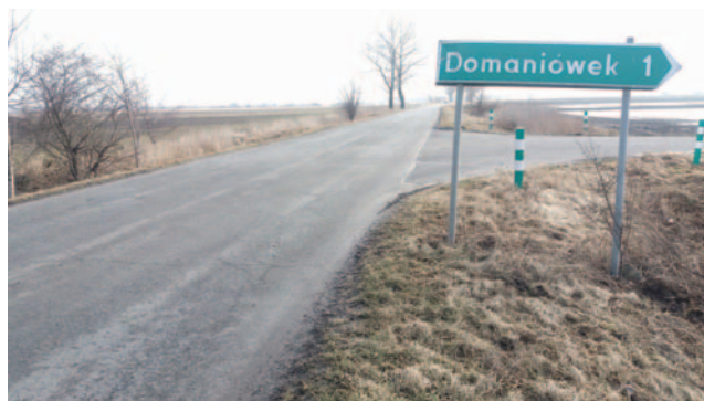
Brak linii krawędziowych i oddzielających pasy jezdni powoduje, że droga powiatowa z Domaniowa do Skrzypnika jest niebezpieczna, zwłaszcza wieczorem i gdy jest mgła
