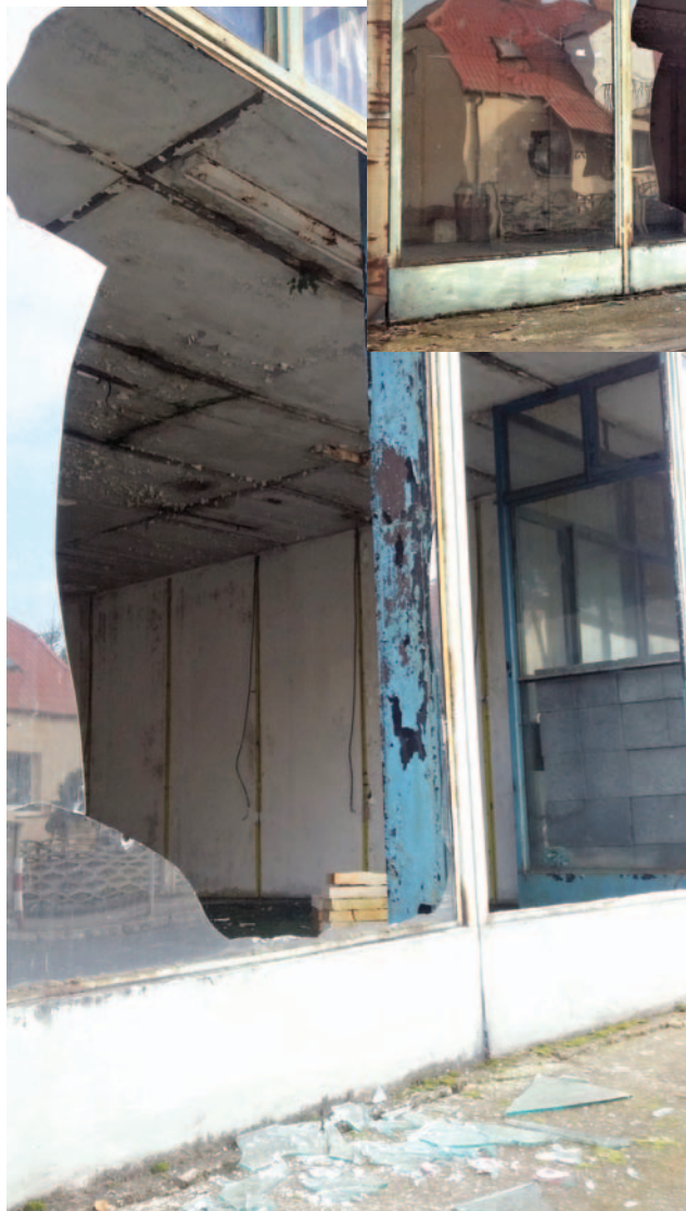
Niebezpieczne witryny z rozbitymi szymbami są niebezpieczne
