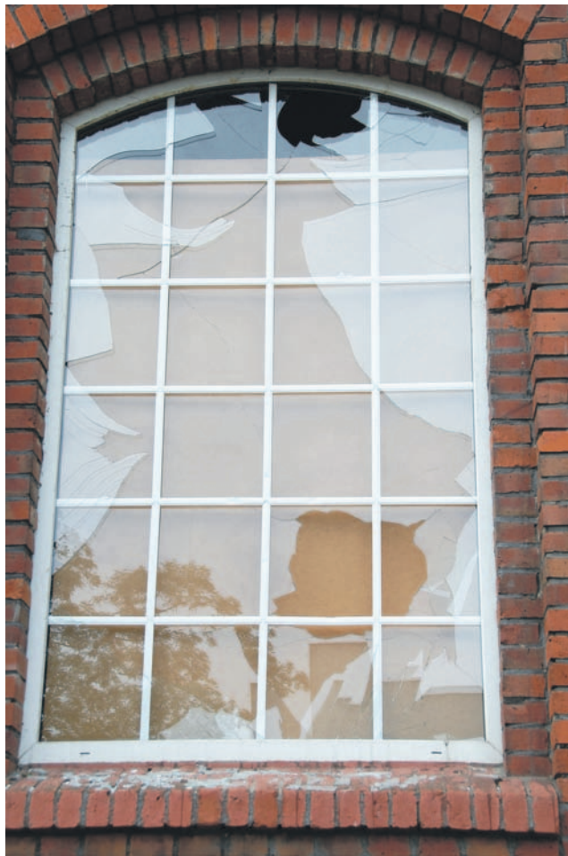
Wybili kilka takich okien. W budynku leżą duże kamienie...
