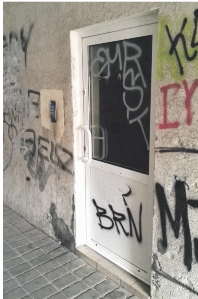
To wejście na klatkę schodową. Drzwi były kilka razy zdewastowane
