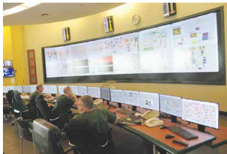
Stanowisko dowodzenia – serce elektrociepłowni we Wrocławiu
