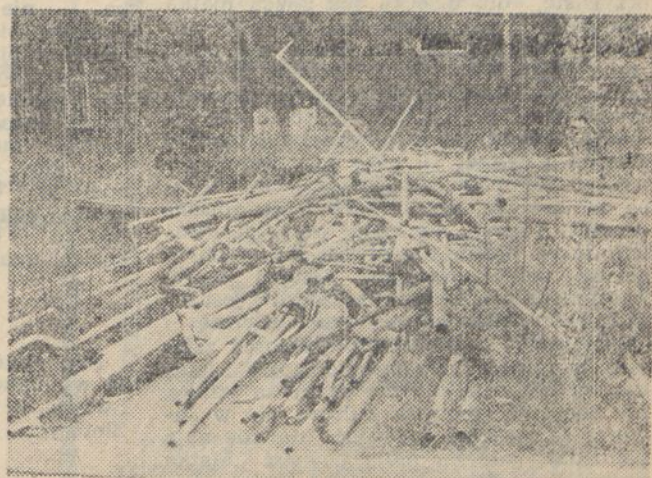
7. Nie wszystkie „wyprute” ze ścian rury instalacyjne zdążono „upłynnić”.
