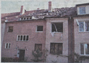
Wybuch zniszczył ściany, okienne i naruszył konstrukcję budynku
