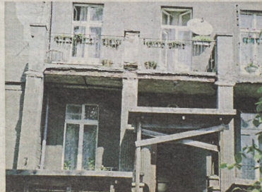
Wiele balkonów jest w opłakanyim stanie. Wymagają naprawdę pilnej naprawy.
