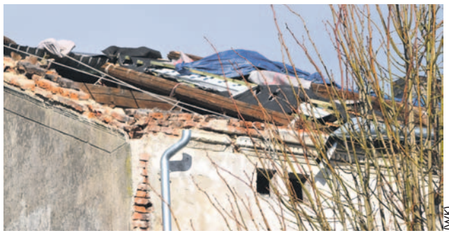
Wichura zerwała dach na domu w Godzinowicach
