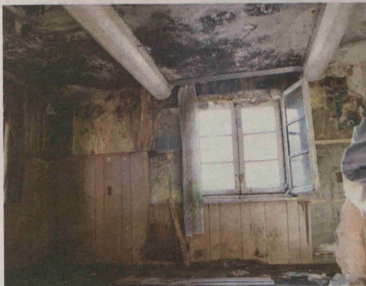
Grzyb w pomieszczeniu na dole przesiąknął już ściany i sufit.
