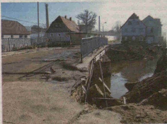
Aktualny stan jednego z 11 zniszczonych mostków na Miedziance...
