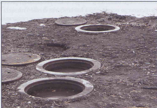
Fot: D. Szypuła. Trójkomorowy osadnik gnilny (widok z góry, osadnik usytuowany w gruncie).
