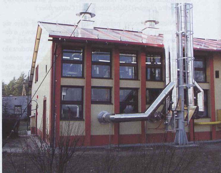
Ryc. 2. Kotłownia Odrodzenia II w Chocianowie (fot. Magdalena Mularska)
