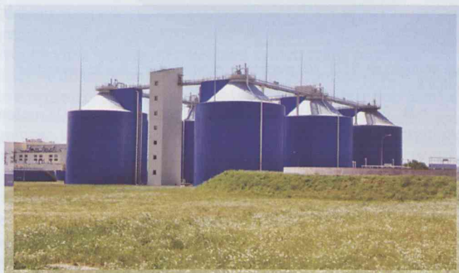
Wrocławskie Oczyszczalnia Ścieków dysponuje sześcioma wydzielonymi komorami fermentacyjnymi (WKF), w których produkowany jest biogaz
