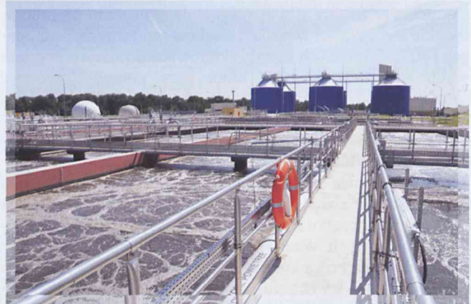
Komory napowietrzania wody
