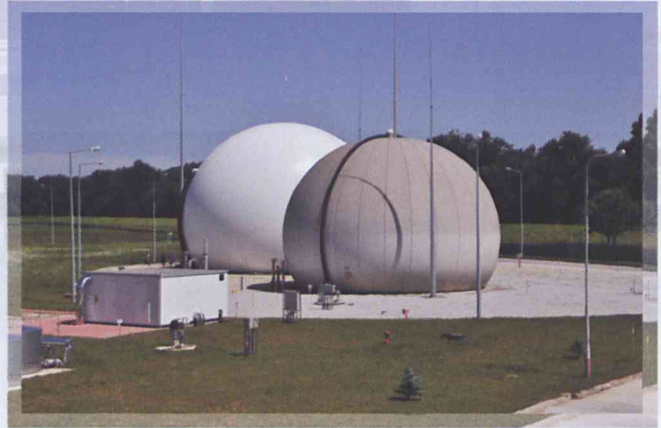
Zbiorniki na biogaz
