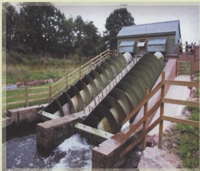
Mala elektrownia wodna z turbiną Archimedesesa
