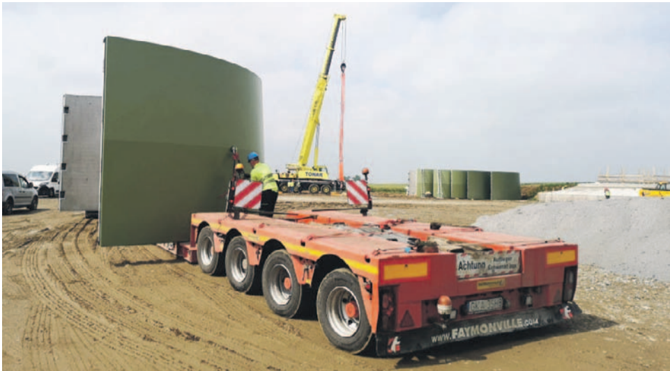
Wieża wiatraka zbudowana jest na dole z kręgów betonowych. Dopiero ostatnia, najwyższa część, jest metalową rurą
