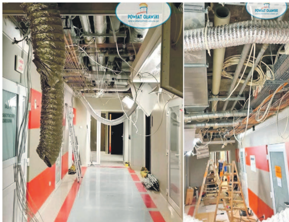
Awaria na SOR to poważna sprawa. Konieczna jest wymiana instalacji hydraulicznej
