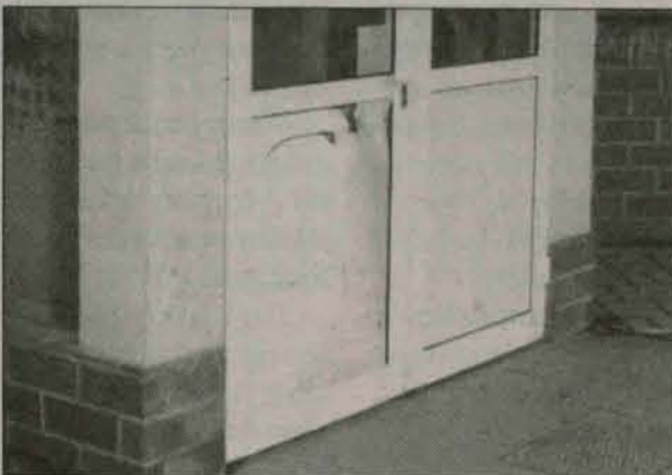
Zniszczone, nowe drzwi
