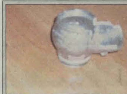
Ten zawór jeszcze nie wykorzystany, a już zdewastowany
