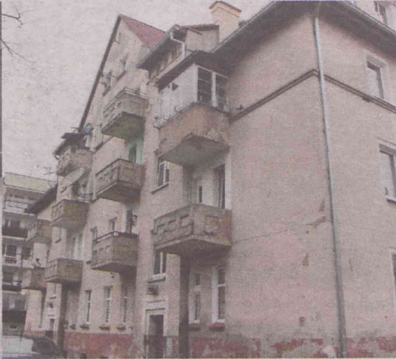
Kamienica przy Krzywoustego 8 czeka na kompleksowy remont
