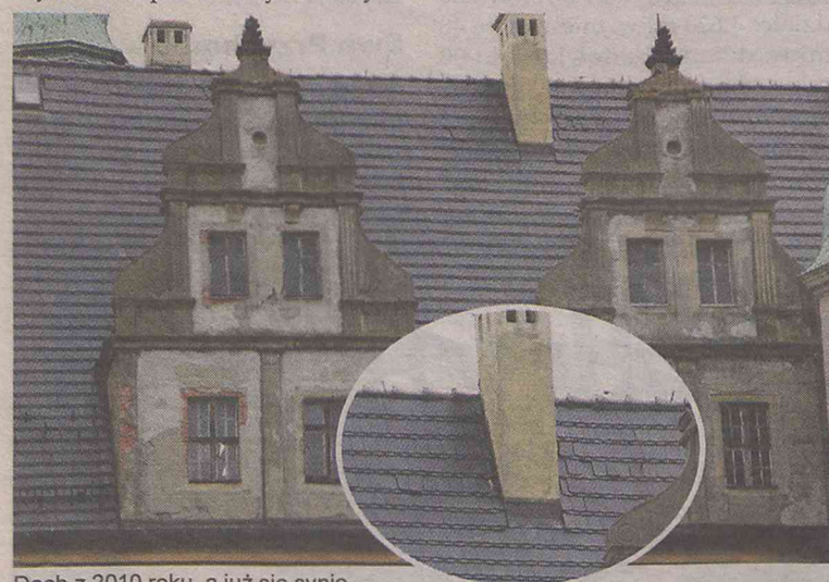
Dach z 2010 roku, a już się sypie...
