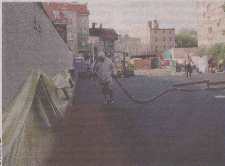
Nawierzchnia nowa, ściana obskurna
