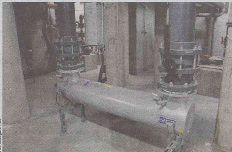
Nowoczesna instalacja poprawia jakość wody
