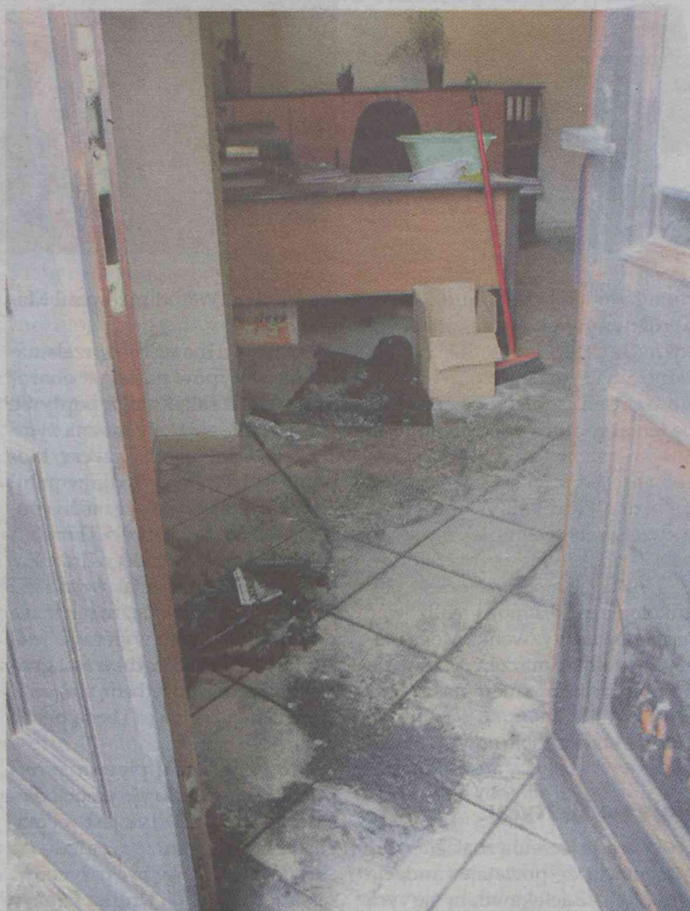
Na szczęście pożar w porę ugaszono
