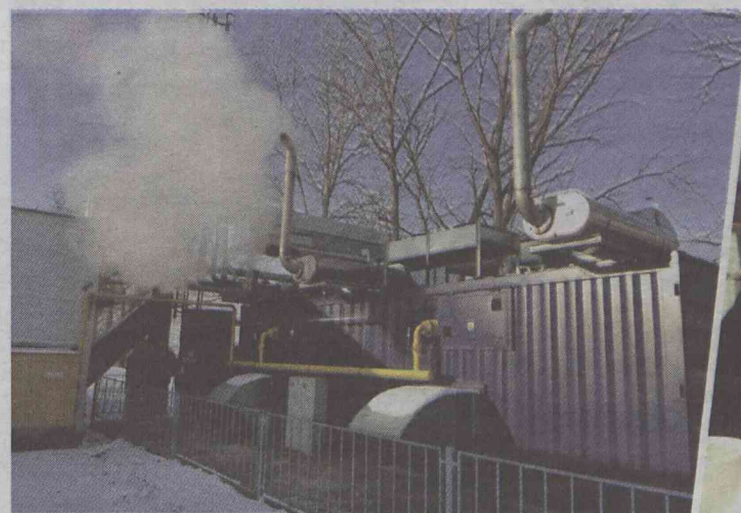
DGG chce sprzedać swoją instalację. Współpraca trwa już 10 lat
