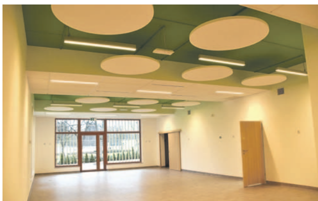
Jednym z nowych rozwiązań zastosowanych w obiekcie jest brak kaloryferów. Wszystkie pomieszczenia w obiekcie, w tym sale dydaktyczne, ogrzewane i chłodzone są za pomocą klimakonwektorów rozmieszczonych przy suficie.
