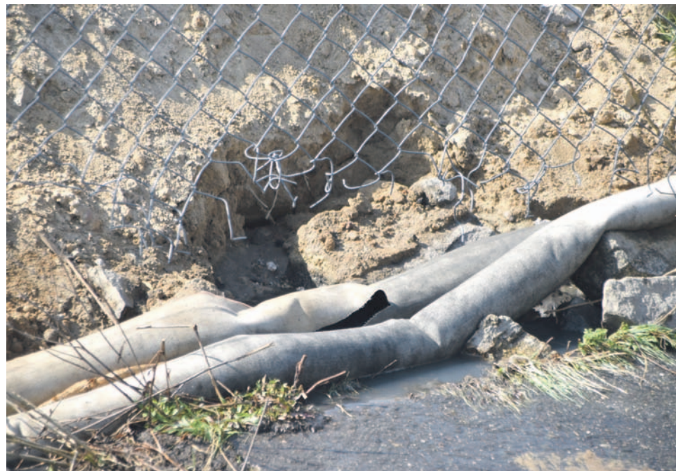
Ktoś uszkodził jeden z tych węży, którym ścieki płynęły do specjalnego zbiornika
