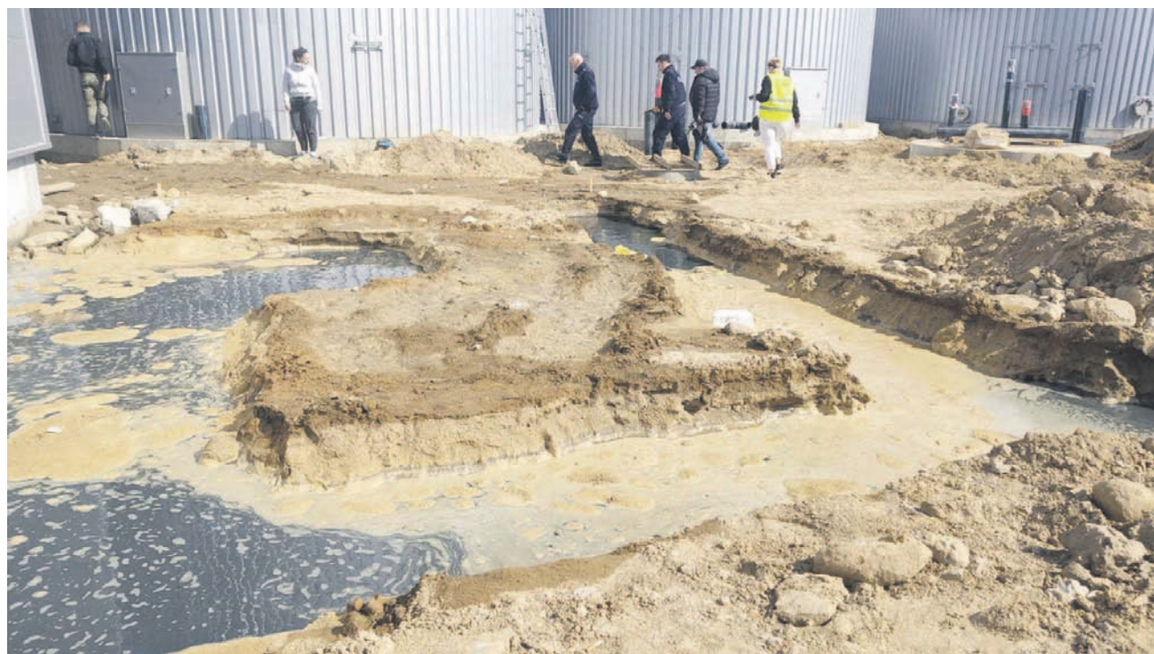
Ktoś przeciął wąż w dwóch miejscach. Pierwszy raz przy wlocie do zbiornika. Wtedy zanieczyszczenia nie dostały się do rzeki. Zalały natomiast teren budowy oczyszczalni ścieków
