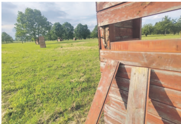
W niektórych miejscach brakuje desek
