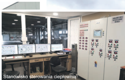
Stanowisko sterowania ciepłownią
