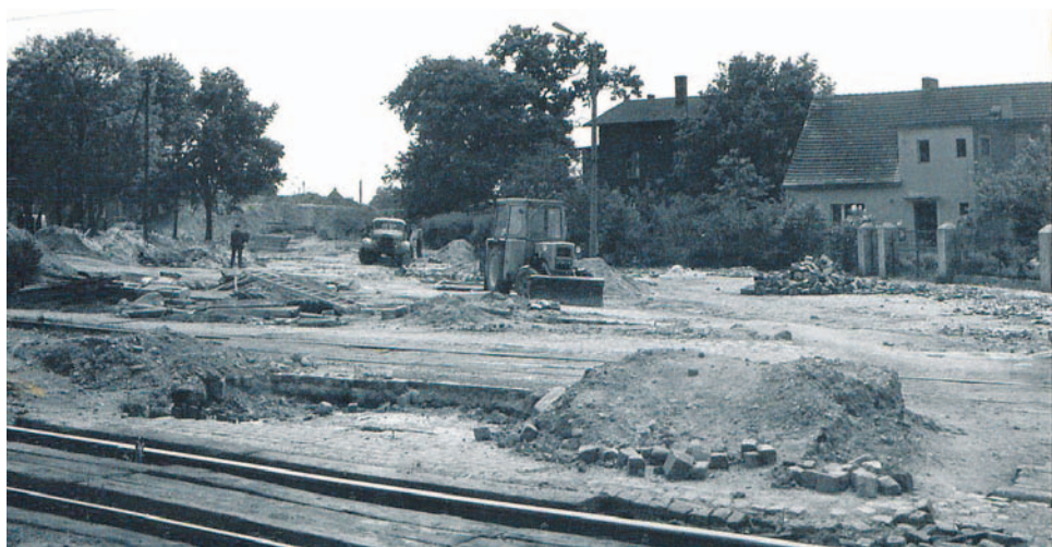
1972. Rozpoczęto prace związane z budową wiaduktu przy ulicy Opolskiej. Po prawej stronie widzimy zabudowania i dalej jest ulica Cicha, której mieszkańcy, chcąc wyjechać samochodem, musieli jechać przez plac budowy lub iść tunelem przez staję kolejową
