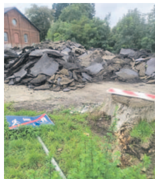
Mieszkaniec zwraca też uwagę na zniszczenia i na to, że nie ma zabezpieczenia przed dostępem osób postronnych
