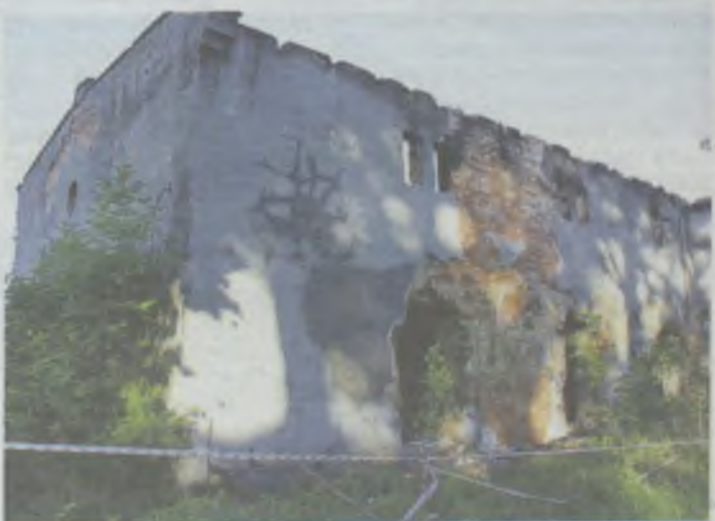
Wypalone ruiny muszą zostać zabezpieczone
