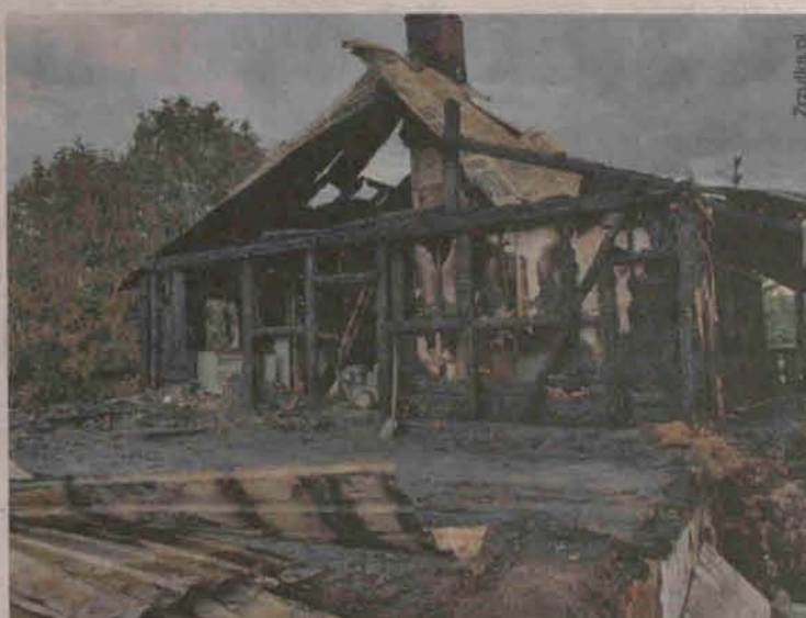
Dom wraz z całym dobytkiem doszczętnie spłonął i nadaje się wyłącznie do rozbiórki.
