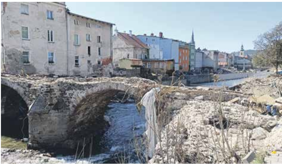
Zniszczenia na moście św. Jana
