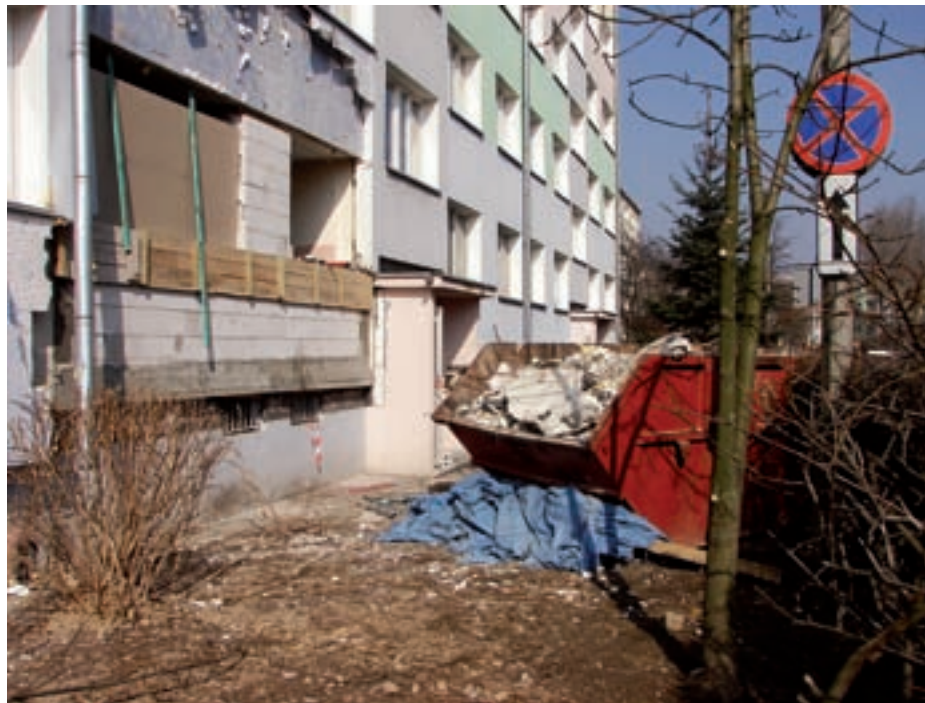
Wypuch spowodował uszkodzenie frontowej ściany. Teraz trzeba było ją odbudować.
